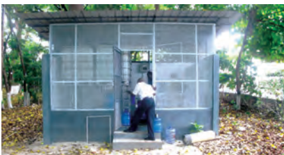
Edicule de sécurisation des appareils de filtrage et traitement de l'eau
